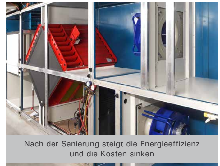
Schwimmbad-Gerät bei Aquarena Neunkirchen Seelscheid vor der Sanierung
