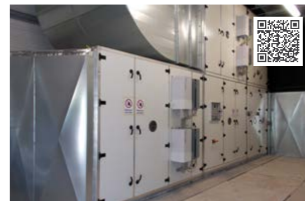
Entwärmung der Konverterstation DolWin 3, 4 Free Line Geräte mit Luftvolumenströmen von 50 000 m 3 /h, Kälteleistungen von 320 kW und integrierten Elektrolüfterheizern.
