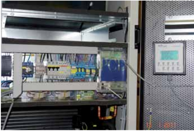
Vergrößerung aus dem Schaltschrank für leistungsstarke Kommunikation. Enlargement of control cabinet for powerful communication.
